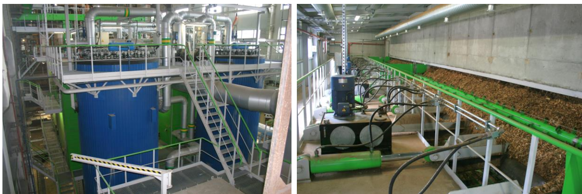
Nuotr.: naujieji vandens šildymo katilai ir biokuro paėmimo įrenginiai Petrašiūnų elektrinėje
